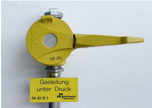
Abbildung 1: verzapfte Gasanschlussleitung im Haus
