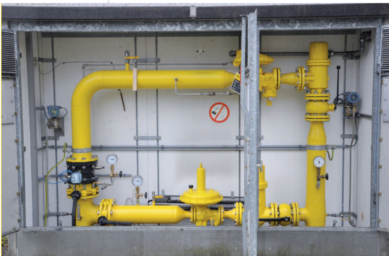
Druckreduzierstation Sonnenthal mit erneuerter Reserveschiene
